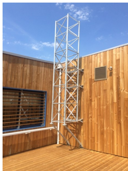
Halle très haut débit – terrasse technique
